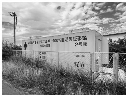
写真4 宮古島の蓄電所
