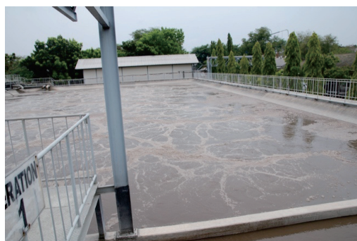
図 2.94 EJIP の生物処理施設
