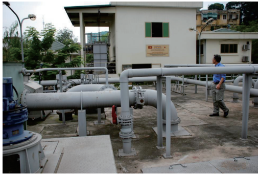
図 2.76 Truc Bach 下水処理場
