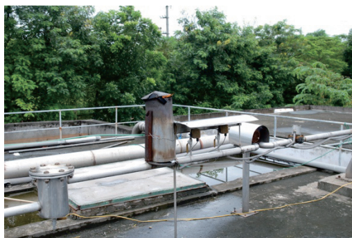
図 2.8 嫌気処理槽上部
