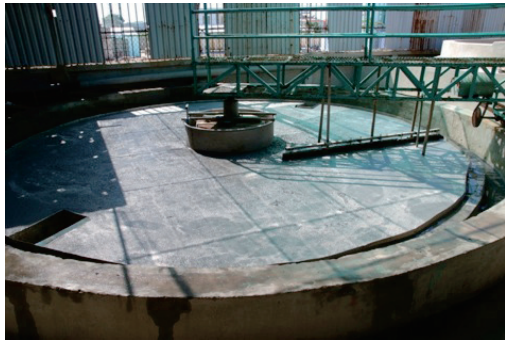
図 2.42 沈殿槽（一面にスカム発生）
