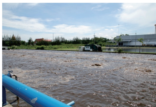
図 2.81 活性汚泥曝気槽
