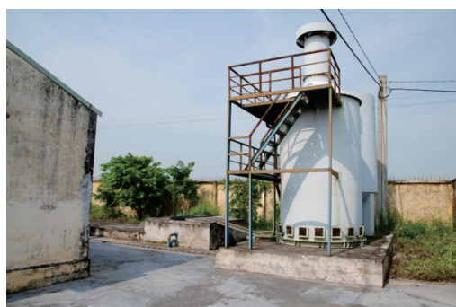
図 2.66 散水ろ床法施設
