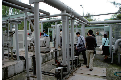
図 2.77 Truc Bach 下水処理場
