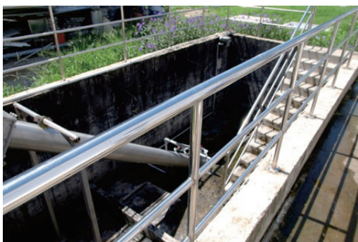
図 2.46 原水流入口にあるスクリーン
