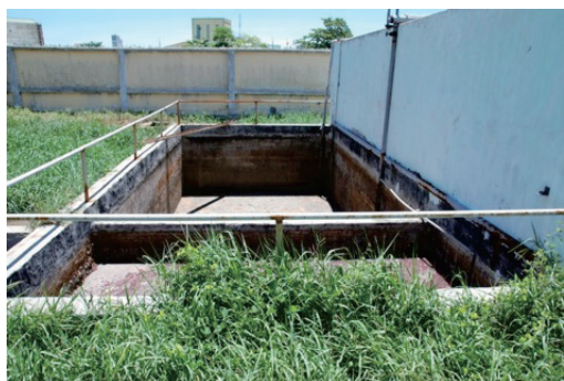
図 2.54 原水槽・調整槽
