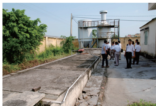
図 2.67 調整槽及び処理槽
