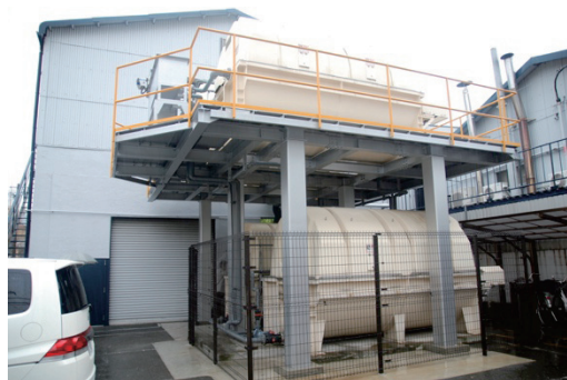
図 5.8 回転円板法（日本） 食品加工廃水処理施設
