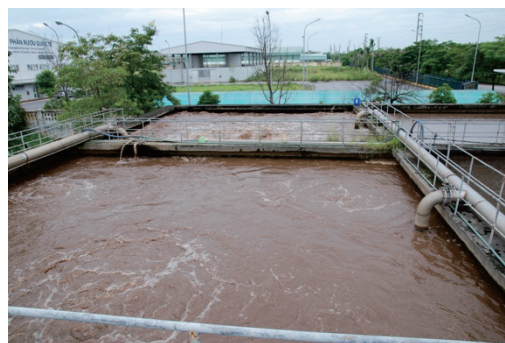
図 2.9 活性汚泥の曝気槽
