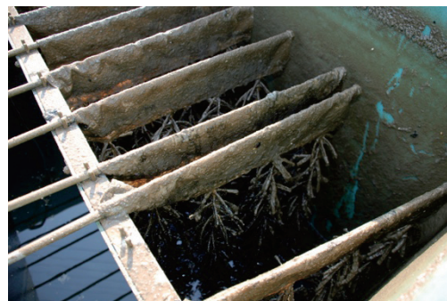
図 5.5 揺動床式生物接触酸化法 (反応槽の水を抜いた状態)
