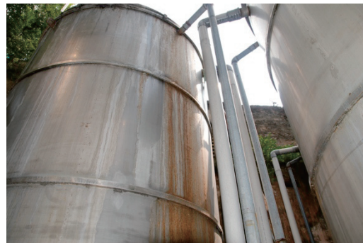
図 2.65 Viet Duc 大学病院の 散水ろ床施設
