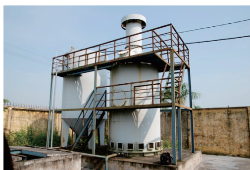
図 5.6 散水ろ床法 (ベトナム) 病院廃水処理施設
