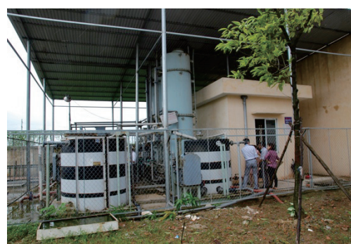
図 2.29 廃水処理施設
