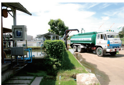
図 2.83 処理水搬出口
