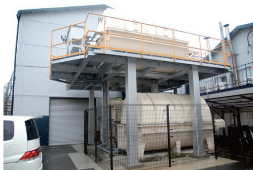
図 5.21 大阪府内の食品工場に 設置してある同装置
