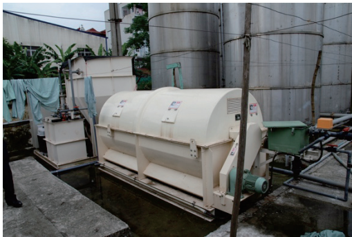
図 5.35 E General Hospital に 設置した回転円板装置
