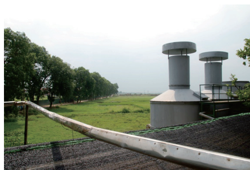
図 5.7 散水ろ床法 (ベトナム) 食品加工廃水処理施設
