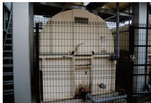
図 5.9 回転円板法（日本） 食品加工廃水処理施設
