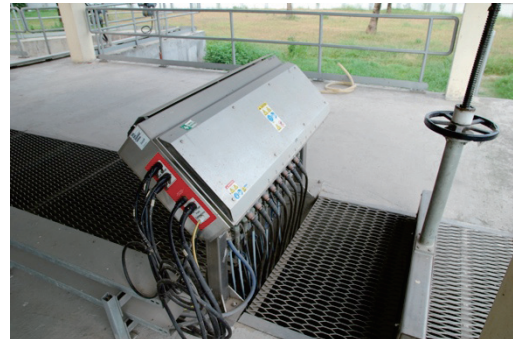
図 2.79 Yen So 下水処理場の UV 装置
