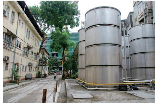
図 2.71 廃水処理施設
